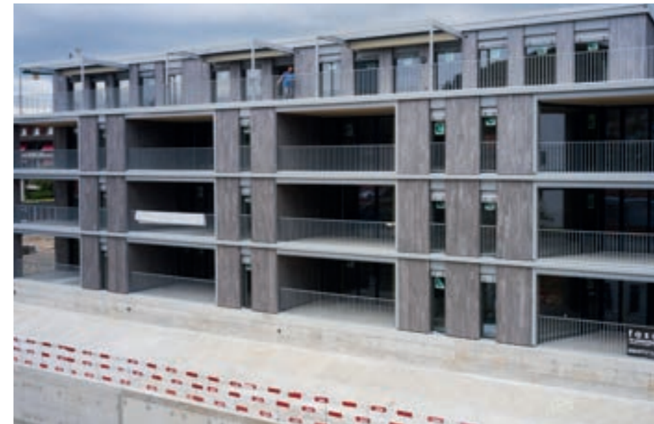
Das Mehrfamilienhaus Fasanenhof in Frenkendorf ist mit der TS3-Technologie gebaut und steht kurz vor Fertigstellung.
