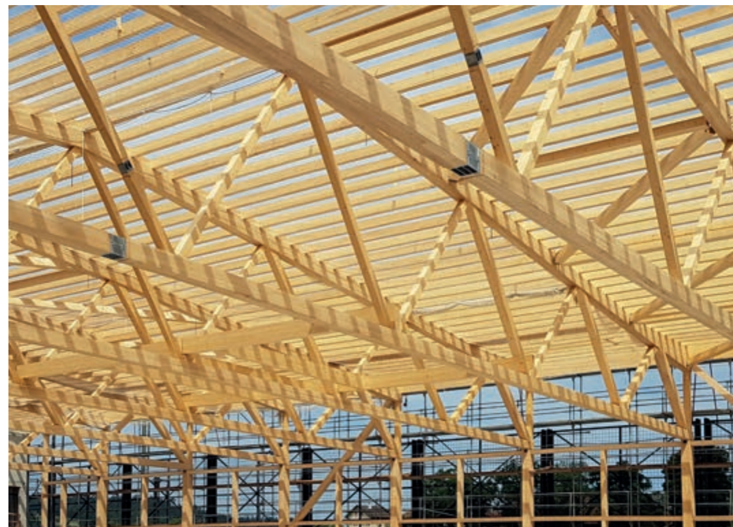
Neubau des Eishockey-Stadions Pruntrut (Raiffeisen Arena): schlanke Fachwerk-Konstruktion mit bis zu 40m Spannweite aus Laubholz (Esche).
